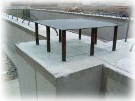
脱型後、基礎天端に柱芯とベースプレート外形寸法を墨出し、精度確認のDubl診断
